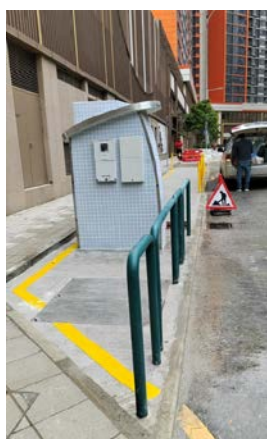
擎天匯停車場外垃圾壓縮桶站
